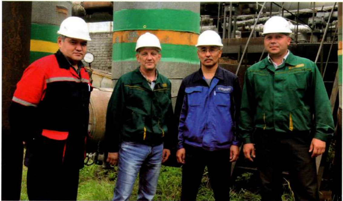
Янгучин С.Х., Кажеев О.Л., Бабаев С.М., Захаров Д.А. на гидравлических испытаниях тепловых сетей
