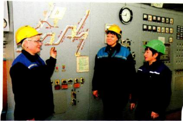
На щите управления
