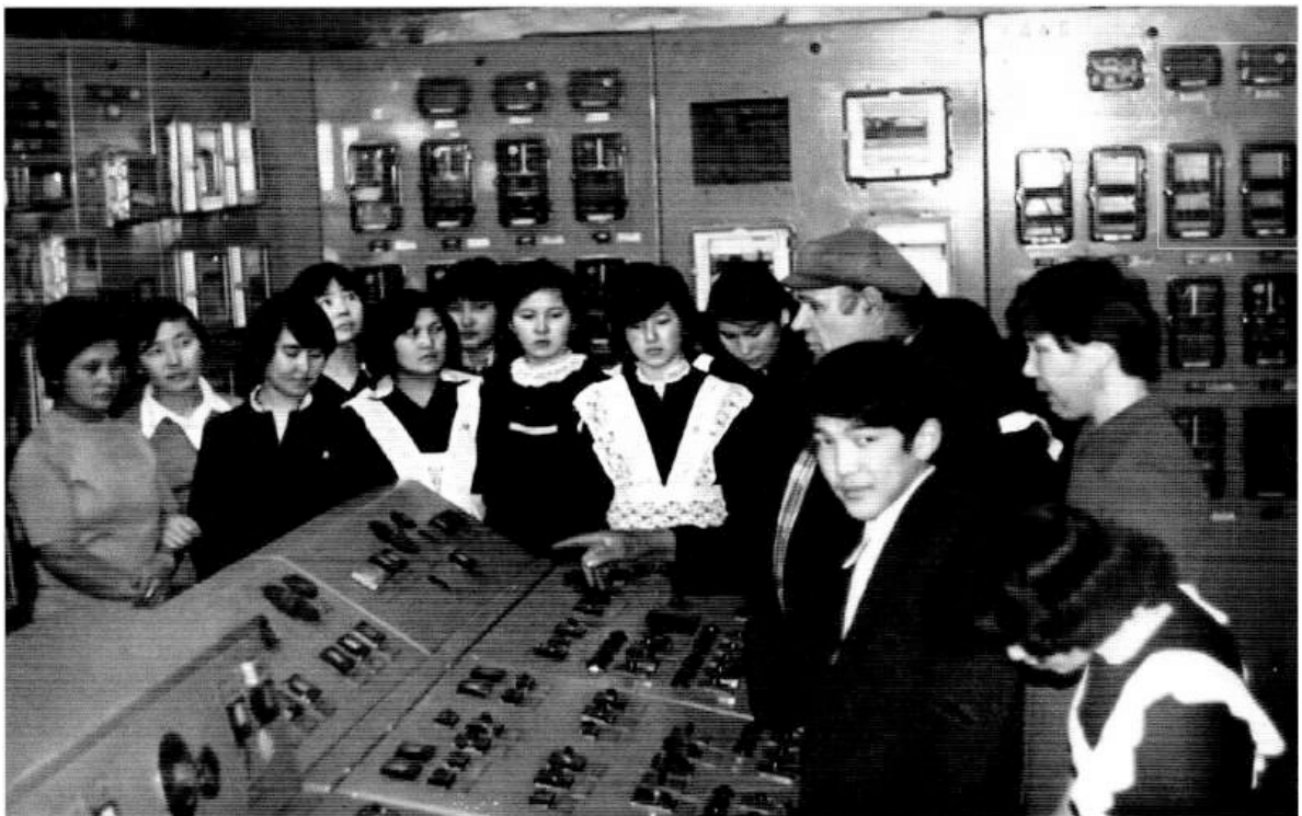
Фронтвик П.Д. Гальченко был в первых рядах этой патриотической акции. И на главном щите управления Павел Денисович рассказывает школьникам принцип работы станции
