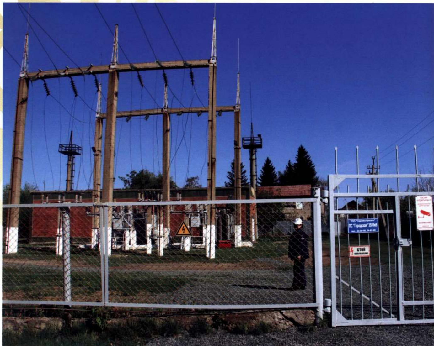
«Горэлектросеть» кәсіпорнының 35/10 кВ қосалқы станциясы – 1967 жылы пайдалануға берілген алғашқы қосалқы станциялардың бірі
